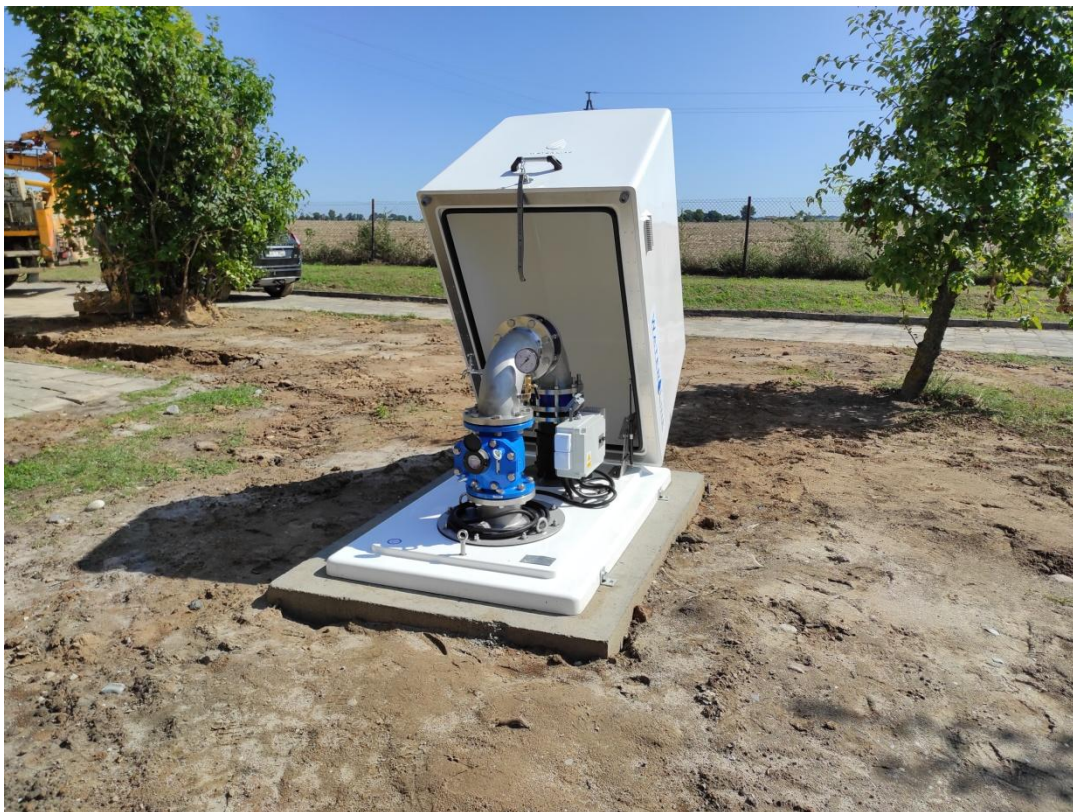
Studnia nr 5 z obudową
