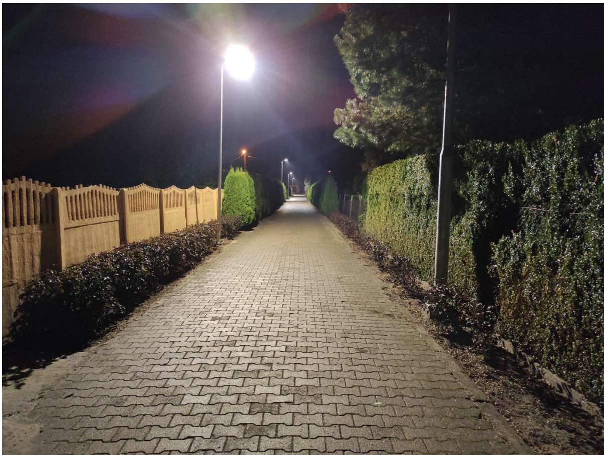
Oświetlenie drogowe ul. Przesmyk po realizacji
